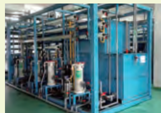
浄化処理(膜濾過)設備
